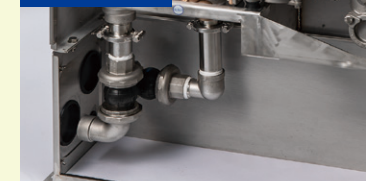
配管孔を大きく
